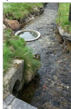
Figure 81 : aménagement prise d'eau 'Ordenne'
