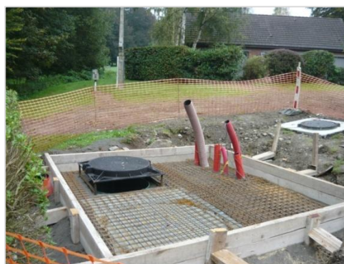
Figure 79 : pompage à Resteigne Domaine
