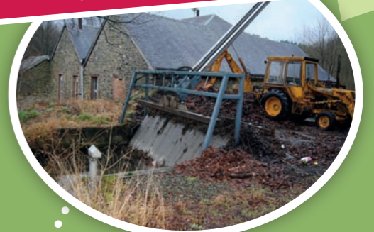
Centrale hydroélectrique Sainte-Adeline
