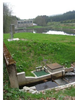
Captage de Bras
