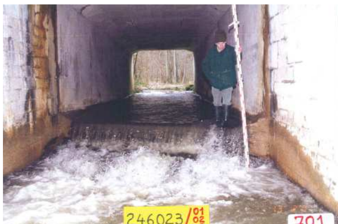
Obstacle à la remontée du poisson
